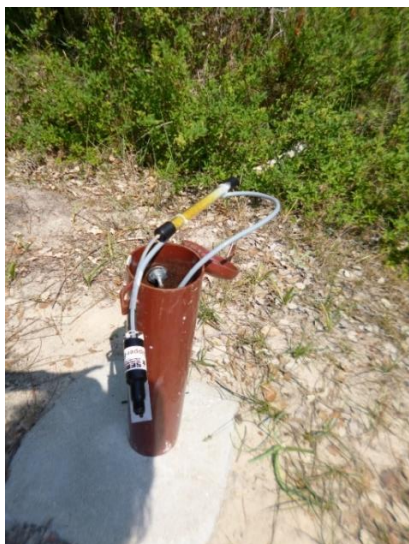
Illustration 13 : PG3 en 2017 avant dégradation
